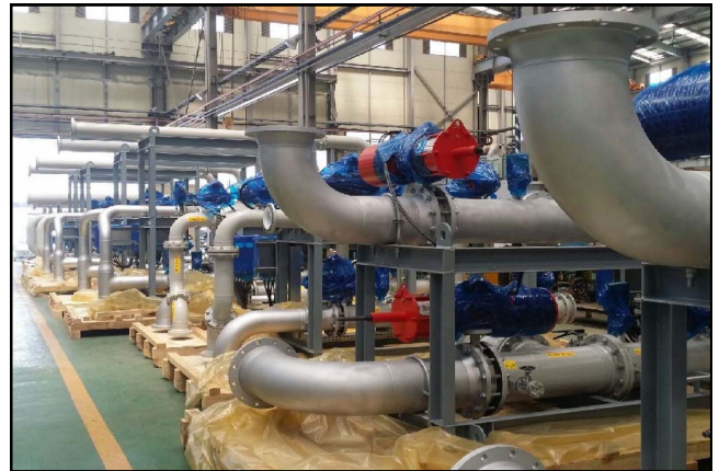
ФРОНТАЛЬНЫЙ БЛОК ТРУБОПРОВОДОВ
