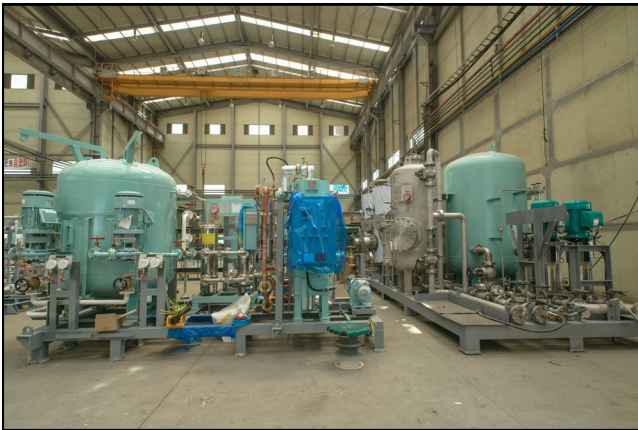
БЛОК СТАНЦИИ ВОДОПОДГОТОВКИ
