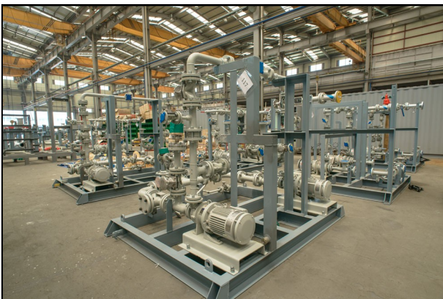
БЛОК ДОЗИРОВАНИЯ ХИМИЧЕСКИХ РЕАГЕНТОВ
